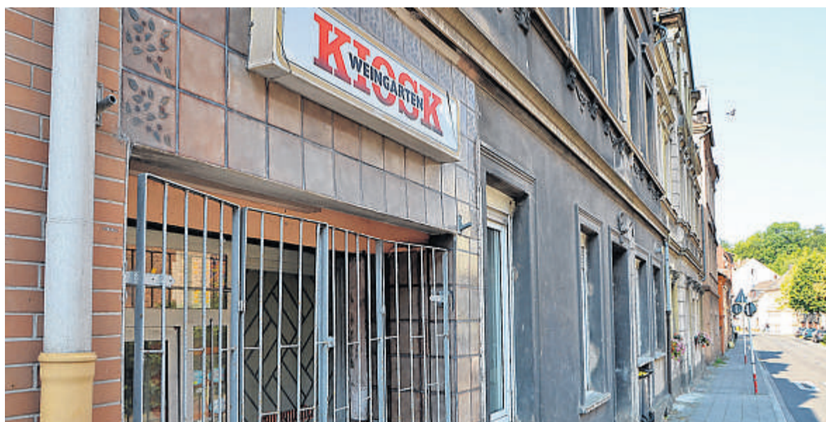
Die Rückseite: In der Weingartenstraße verfallen die Häuser trotz bester Anbindung und Nähe zum Phoenix-See. Die Immobilien, sagt die Stadt, sind meist in privater Hand.
